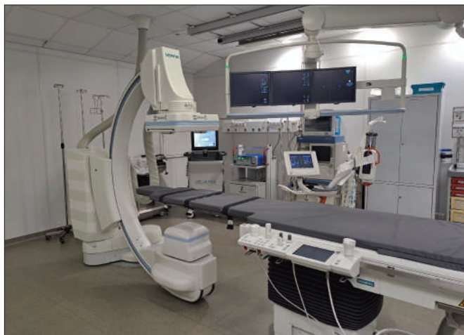
Рис. 1. Современный напольный ангиографический комплекс Artis Zee Floor (Siemens, Германия), установленный в рентгеноперационной ОРХМДил ФГБУ «НМИЦ онкологии им. Н.Н. Петрова» МЗ РФ. Ангиографический комплекс оснащен плоским детектором третьего поколения размерами 40х30 см, что дает возможность выполнять двухфазную ПДКТ непосредственно во время рентгенохирургических вмешательств с применением как внутриапериартериального, так и внутривенного контрастирования. Программный пакет iGuide Needle Guidance (Siemens, Германия) и лазерная подсветка позволяют использовать трехмерную чрескожную навигацию в режиме реального времени при проведении чрескожной биопсии, чрескожной энергетической абляции, чрескожного дренирования и других чрескожных вмешательств. Программный пакет Embolisation Guidance (Siemens, Германия) позволяет использовать трехмерную внутрисосудистую навигацию в режиме реального времени при проведении суперселективной катетеризации и эмболизации/химиоэмболизации артерий, питающих опухоли печени и опухоли других локализаций, а также для автоматического поиска артерий, являющихся источником кровотечения. Программный пакет 3D/3D Fusion (Siemens, Германия) позволяет выполнять слияние 3D-массивов данных, полученных посредством выполнения ПДКТ как с 3D-массивами других ПДКТ-исследований (выполненных на разных этапах вмешательства, например, до и после проведения микроволновой абляции), так и с 3D-массивами любых других модальностей лучевой визуализации, в том числе МРТ, МСКТ, ПЭТ и ПЭТ-КТ.
